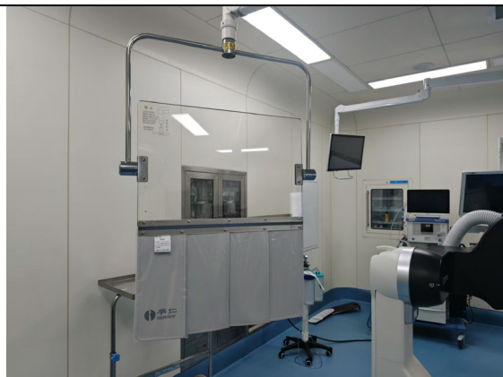
介入手术室 2DSA 铅防护吊屏
