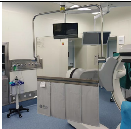
介入手术室 1DSA 铅防护吊屏
