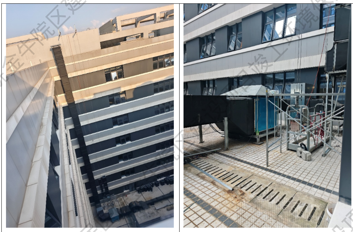
废气排气筒及处理设施
